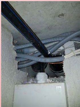
Presenza di punti di infiltrazione nell'edificio del radon
