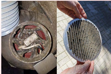
Manutenzione carente di griglie e ventilatore
